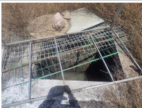
废水收集池（10m 3 ）
