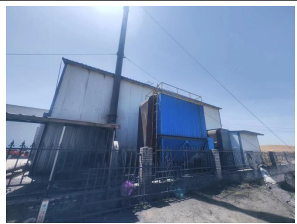
旋风+布袋除尘器+35m 排气筒
